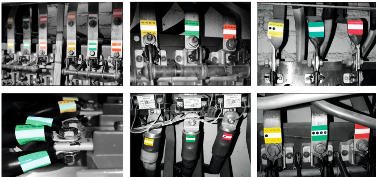
Рис. 2. Примеры установки и срабатывания термоиндикаторов
