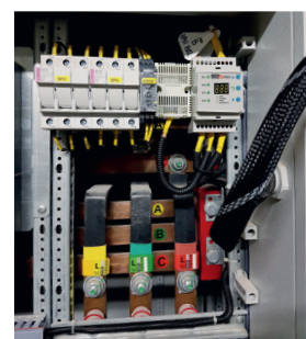
Пример расположения головного модуля СГД, ВГС и ТГН в распределительном щите
